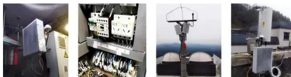
图为：风电设备设施
